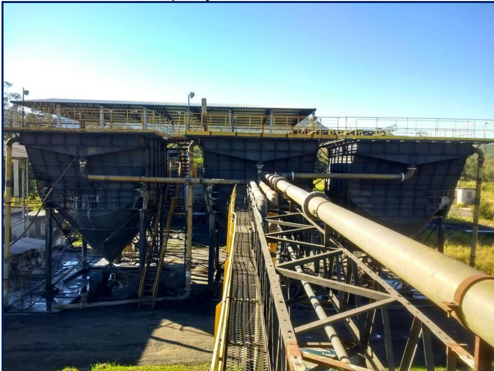
Figura 12 – Decantadores em operação na ETE.
