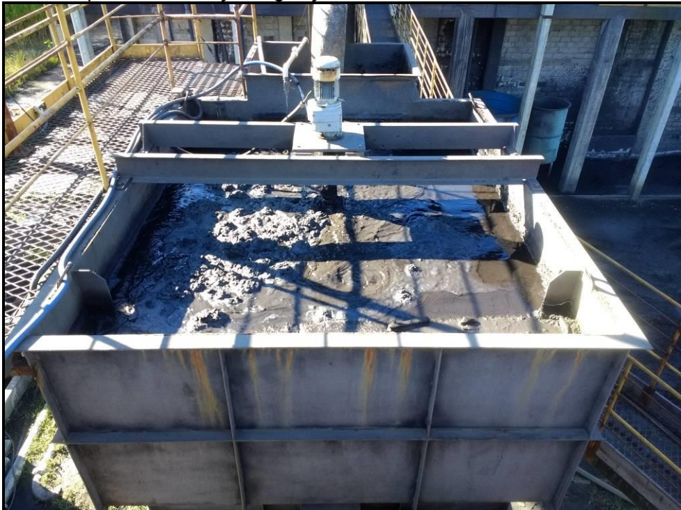
Figura 11 – Tanque de floculação/agitação lenta.
