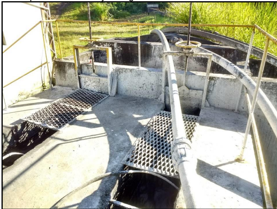
Figura 10 – Tanque de neutralização seguido de calha Parshall.
