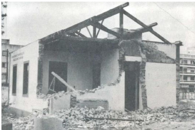
Figura nº 2- Casa do Agente ferroviário com parte destruída em maio de 1995 – Informativo do IAB.
