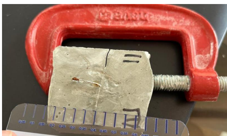
Figura 14 – Medição da abertura de fissura com fissurômetro
