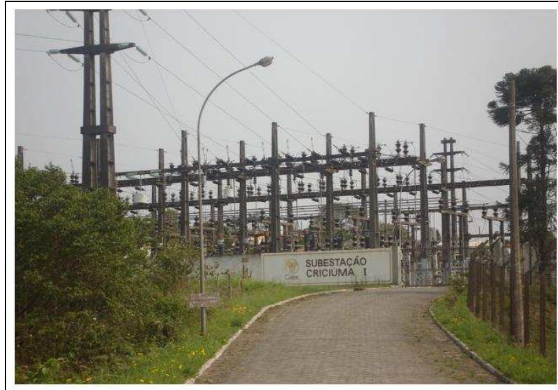
Figura 13. Subestação Criciúma I
