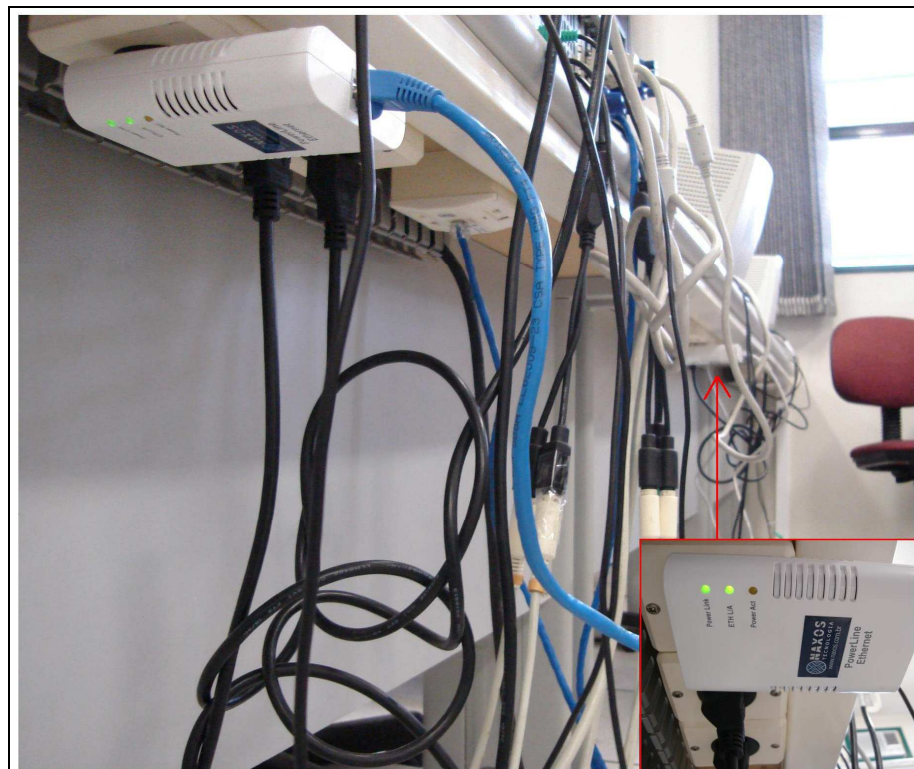
Figura 55. Adaptadores PLC em teste com a rede elétrica estabilizada
