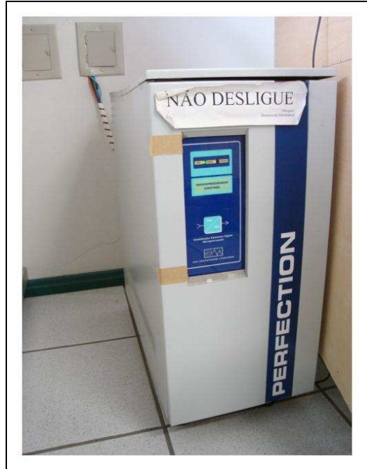
Figura 54. Estabilizador da rede elétrica do laboratório de informática
